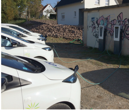
Figure E.13: Two charging stations with four cars connected for charging, source: M. Gabel, Strasbourg Électricité Réseaux.
