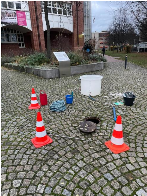
Abb. 21: Aufbau zum Hochpumpen des Grundwassers zur Beprobung und zur Herstellung der Injektionslösung
