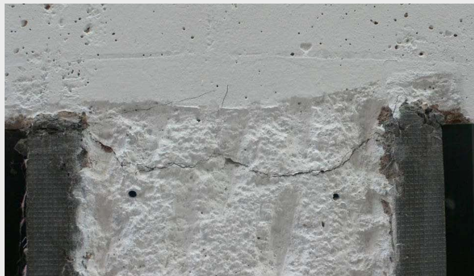
Abb. A2.108: Rissbildung in einer seitlichen Ansicht des Balkens
