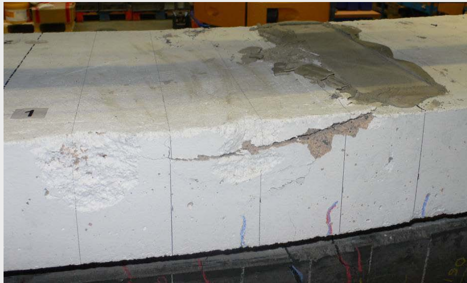
Abb. A2.84: Versagensbild im oberen Bereich des Balkens
