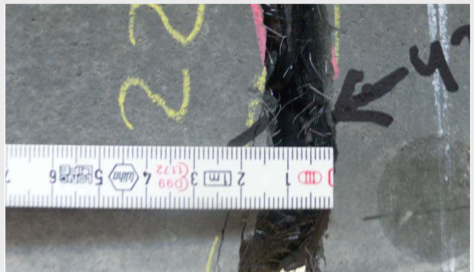
Abb. A2.60: Messung der Rissbreite
