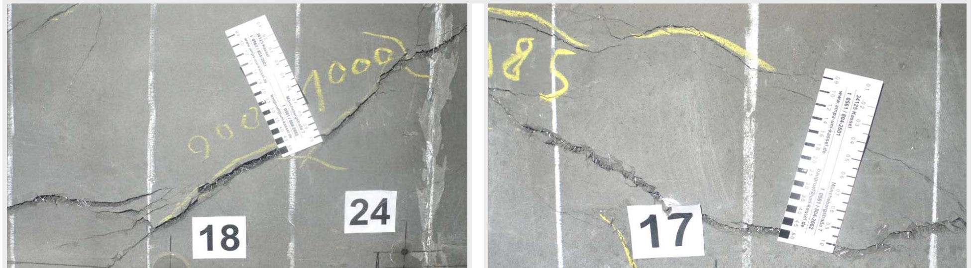
Abb. A2.123: Manuelle Messung der Rissbreite
