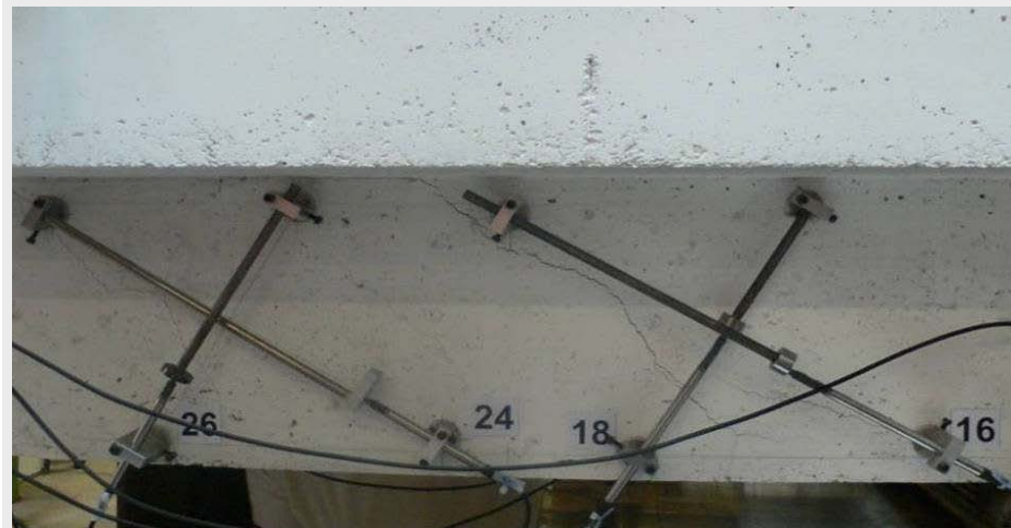
Abb. A2.92: Rissbildung während der Versuchsdurchführung
