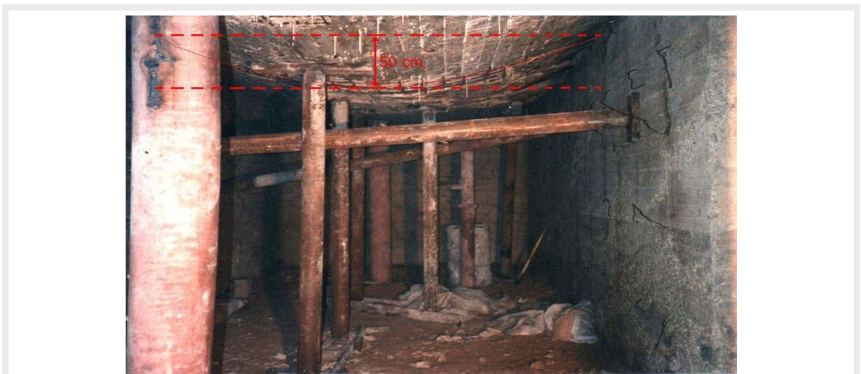
Abb. 3.21: Maximale Durchbiegung einer Kellerdecke von 50 cm unter einem Gebäudeeingang (eigenes Foto, Damaskus, 1996)
