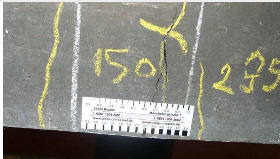
Abb. A2.86: Rissbildung in der Balkenmitte
