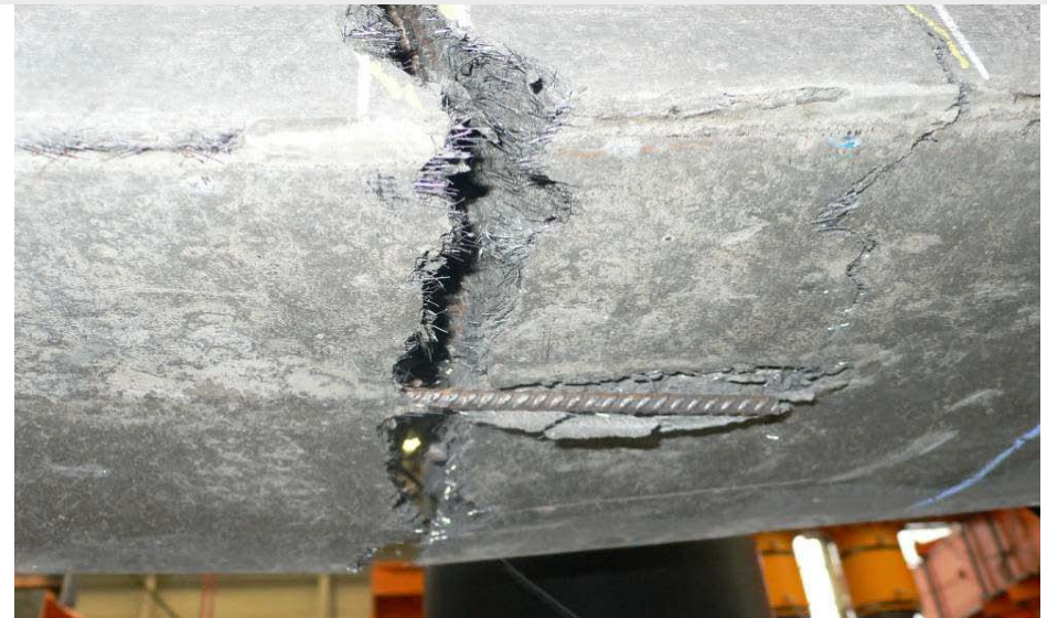
Abb. A2.85: Brechung eines Stabstahls in unteren Bereich des Balkens
