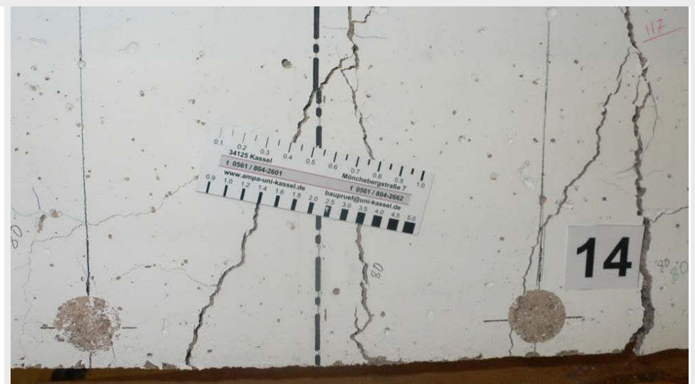
Abb. A2.75: Rissbildung in der Balkenmitte
