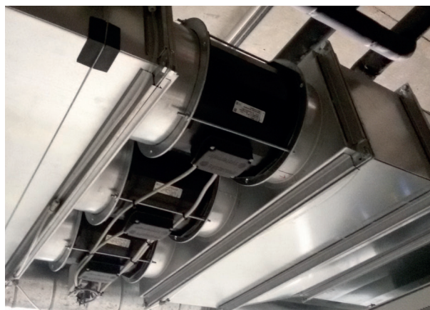
Abbildung 5.2: Einbausituation von 3 parallelen dezentralen Axialventilatoren
