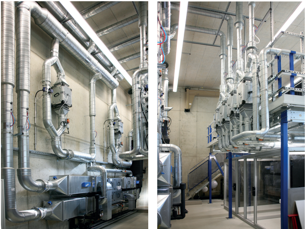
Abbildung 5.7: Lüftungsversuchsstand am Fachgebiet Technische Gebäudeausrüstung der Universität Kassel (links das modulare Zentralgerät, rechts die versorgten Testräume).
