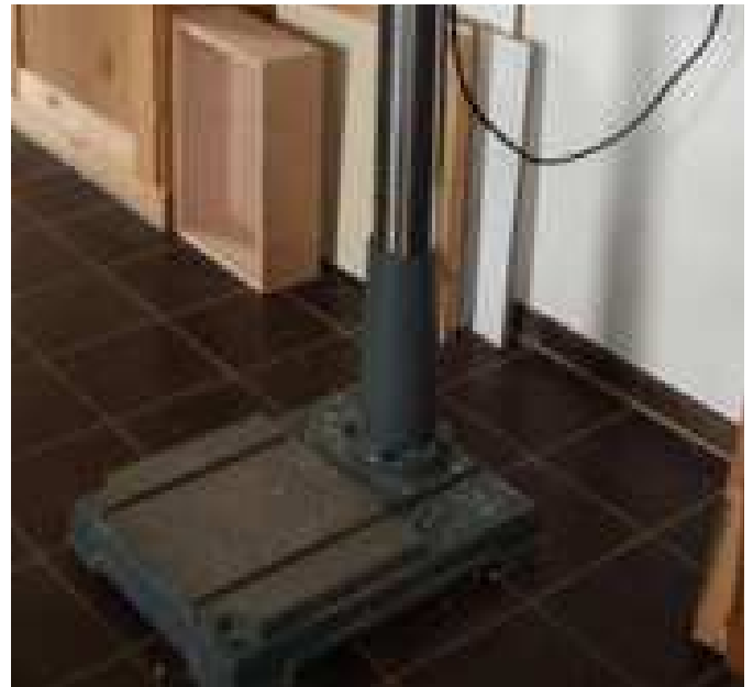
Abb. 16: Bohrmaschine nicht am Boden befestigt
