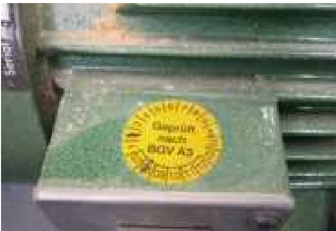
Abb. 18: Prüfristen der elektrischen Betriebsmittel erheblich überschritten
