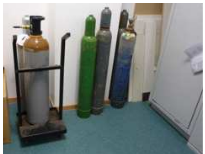
Abb. 21: Gasflaschen nicht gegen Umfallen gesichert, Flaschenventil bei der Lagerung nicht mit Abdeckkappe versehen (teilweise)
