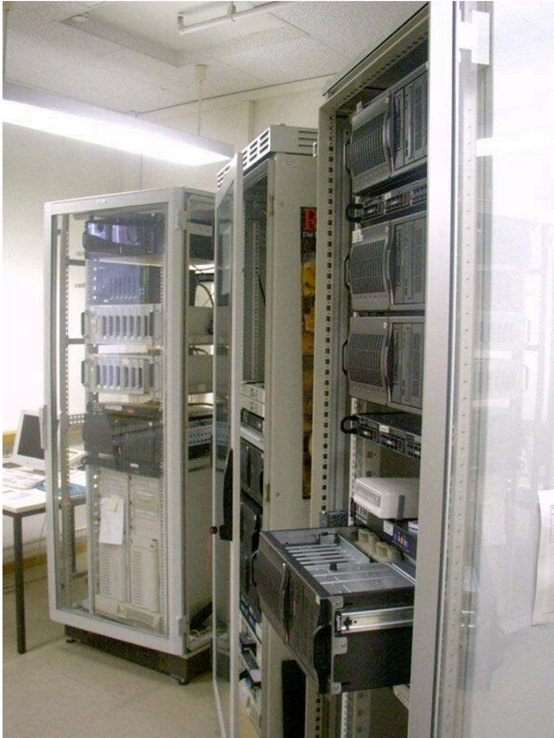
Abb. 2: Blick in den Serverraum mit den 19“-Schränken der Terminal- und CD-Serverinstallation
